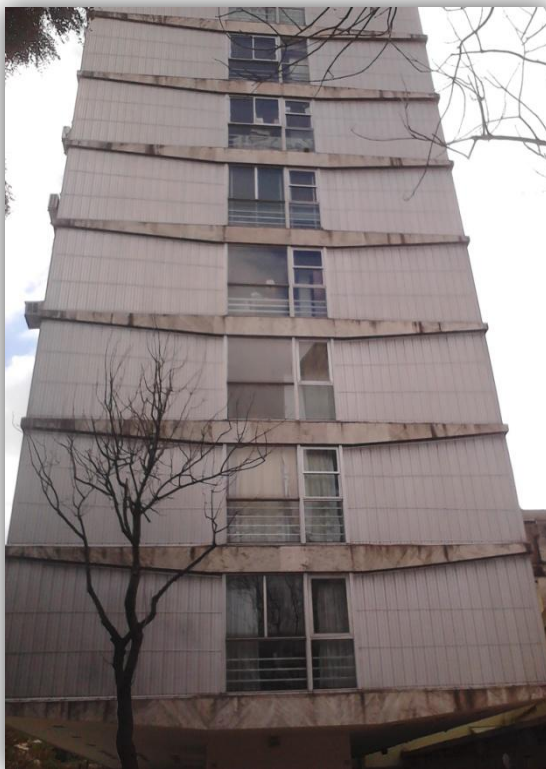
Foto 2 - foto lateral donde se observa el incremento de espesor en la zona central de las losas
